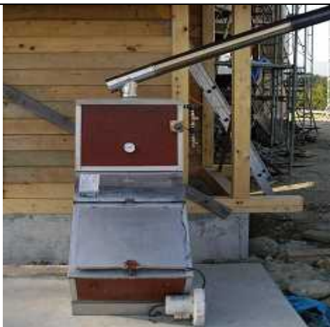
＜ウッドボイラー＞2006年設置 ・貯湯容量・・・220ℓ 自動給水 ・熱源能力・・・33000-40000kcal/h ・メーカー・・・ATO
