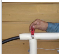
太陽熱温水器から給湯
